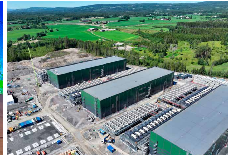
Tilgangen på strøm, infrastrukturen og samarbeidet mellom kommuner og næringsliv gir Heggvin en sterk posisjon. Her bygger Green Mountain Europas største datasenter av sitt slag.
